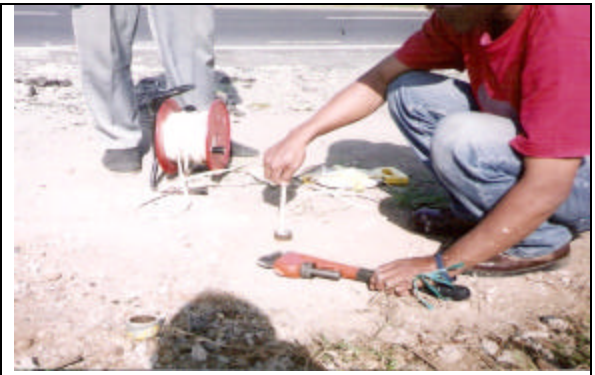
Pengujian Ektensometer di Km Sby 153+750
