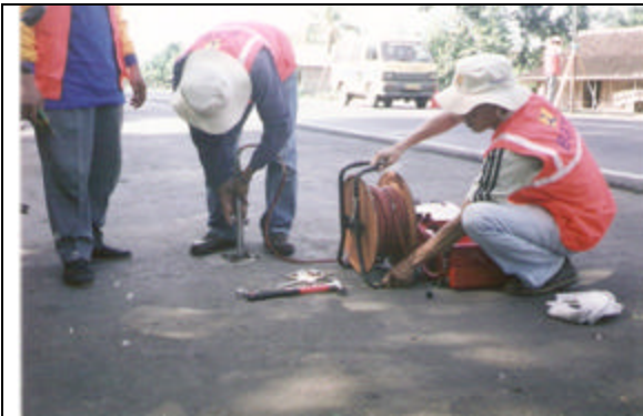
Pengujian Inklinometer di KM Sby 172+ 450
